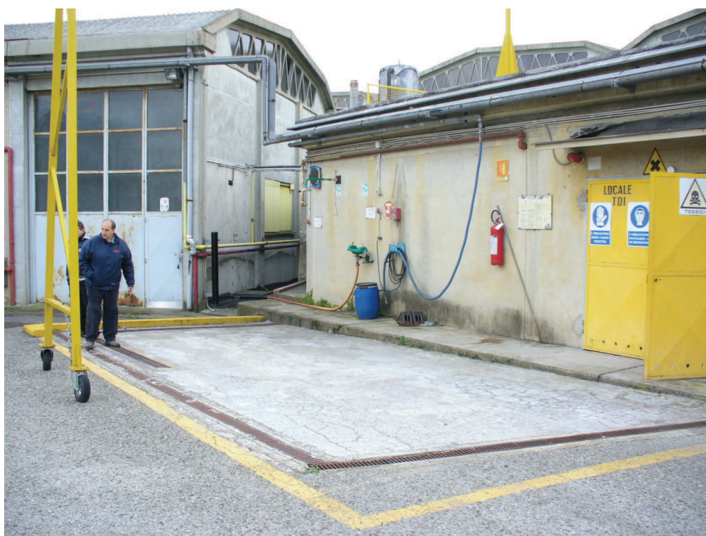
Foto 4 – area di scarico del TDI con i dispositivi di primo soccorso e le griglie di raccolta in caso di sversamento fortuito, con recapito verso una cisterna a tenuta stagna
